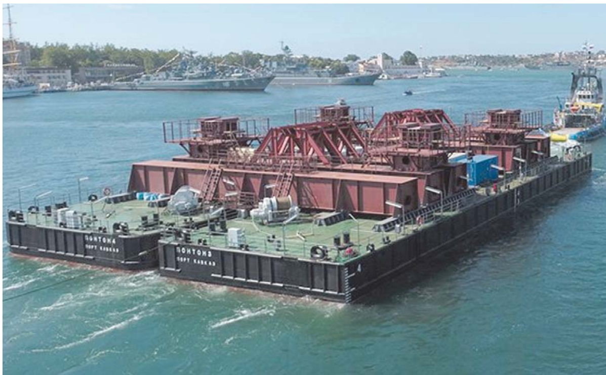
Рис. 2. Буксировка сдвоенных технологических площадок к месту работ по установке арок Крымского моста через Керченский пролив
